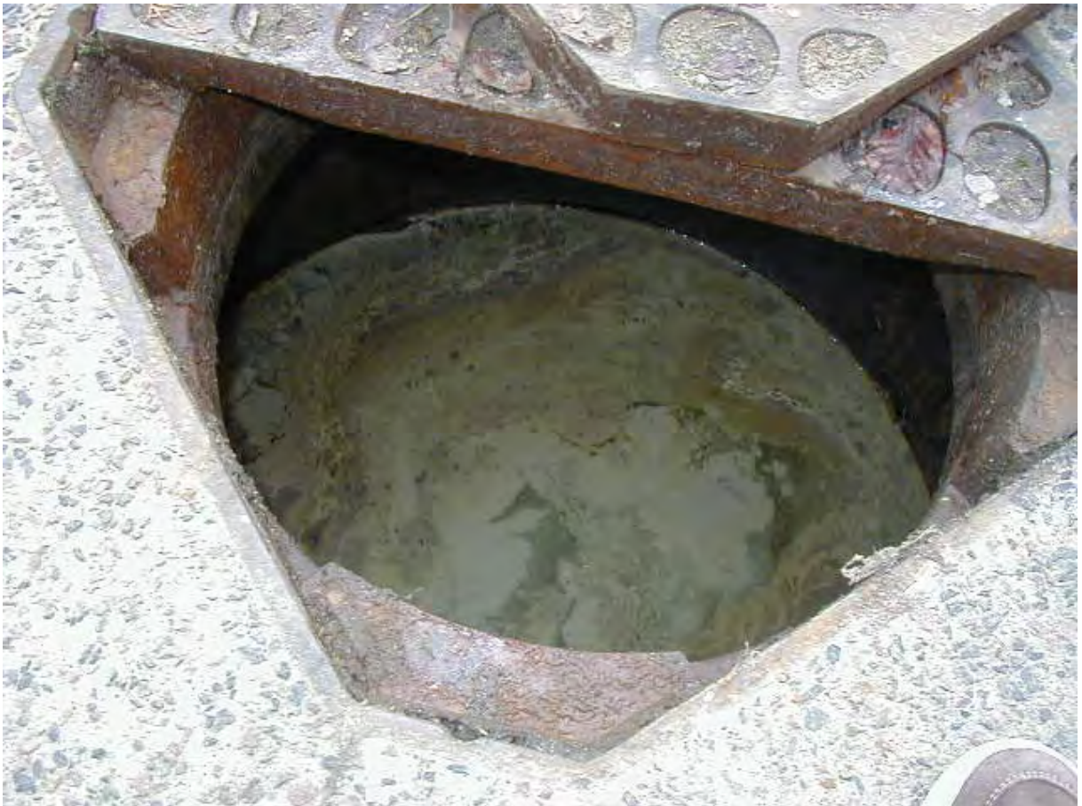
GHK10 Olieudskiller (bygning 120).
