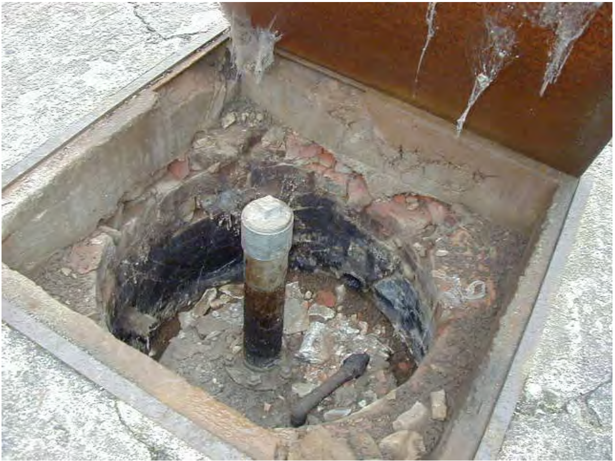
GHK07 Påfyldningsstuds til tankanlæg (bygning 129).
