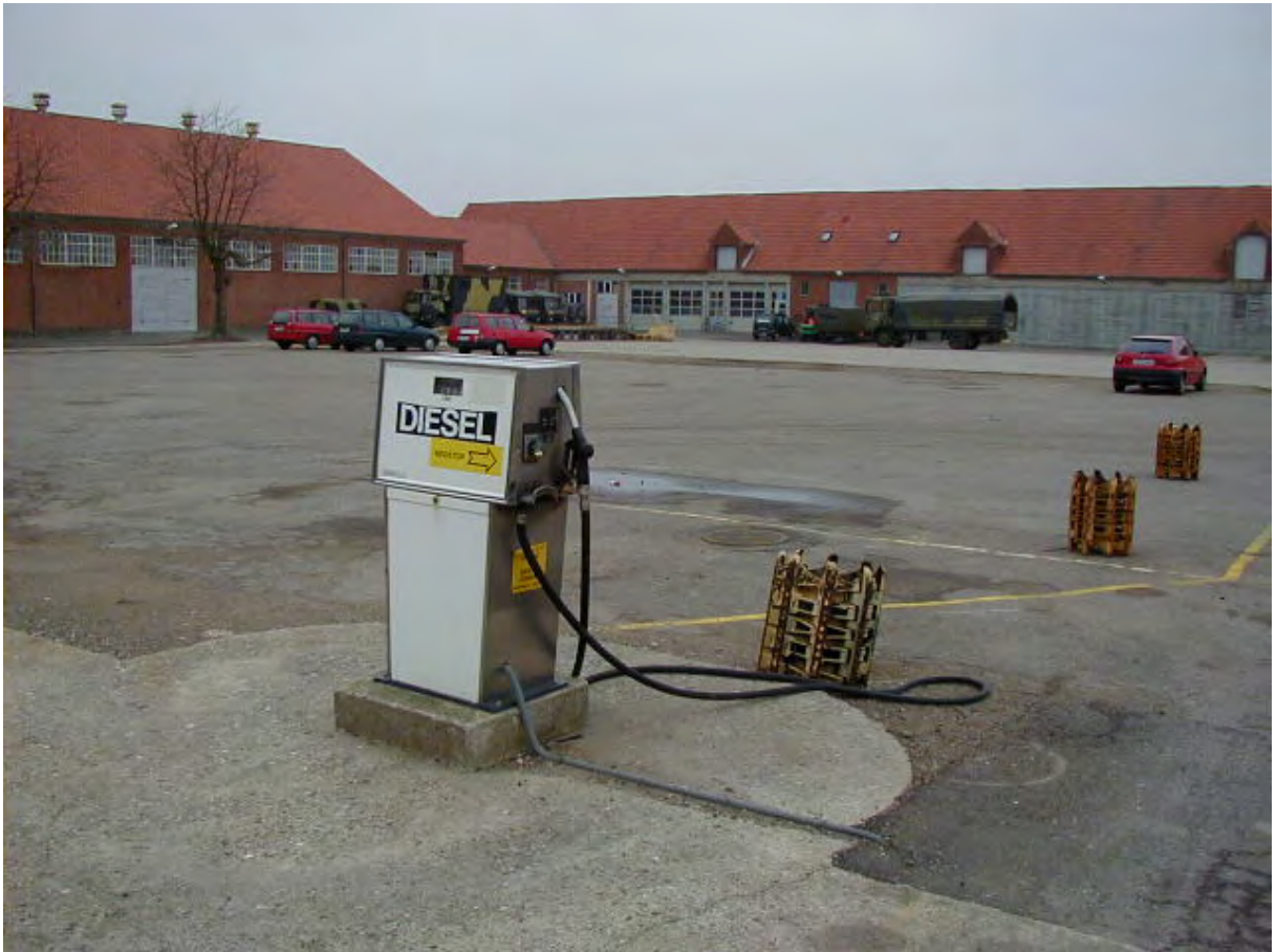
GHK23 Tankanlæg (bygning 12).
