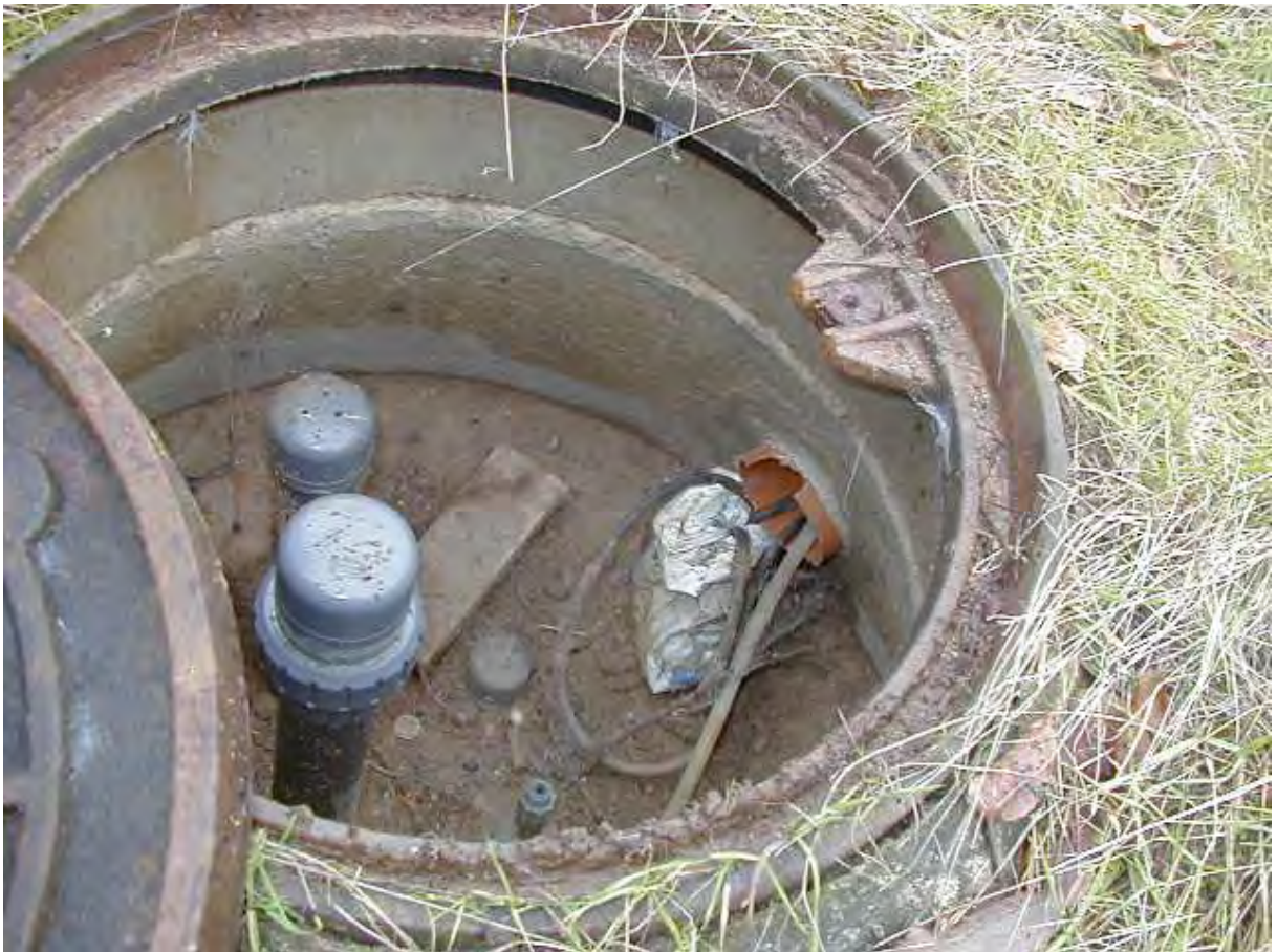
GHK06 Kemikaliepåfyldning til svømmebassin (bygning 130).
