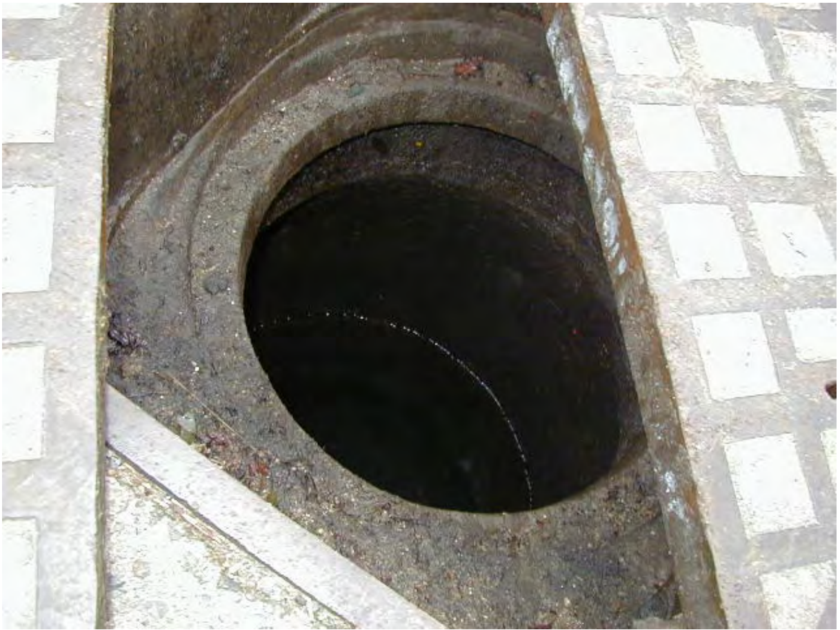
GHK25 Olieudskiller (bygning 107a).
